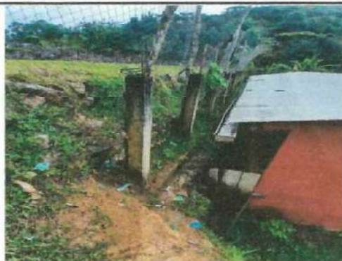
Foto 4: Muro de contencion con necesidad de completacion de bloques.
