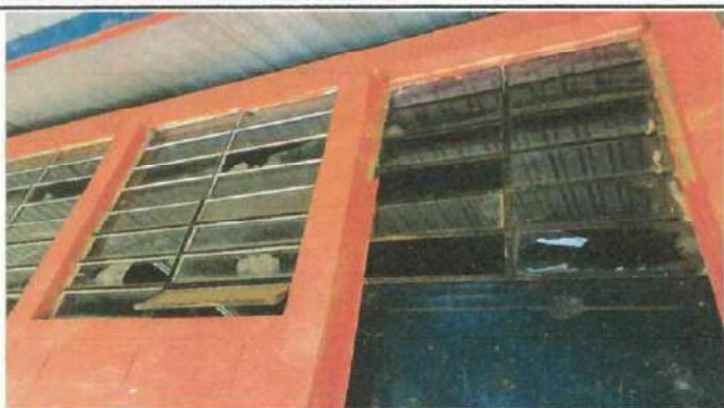
Foto 1: vidrios con necesidad de cambio y mantenimiento de estructura.
