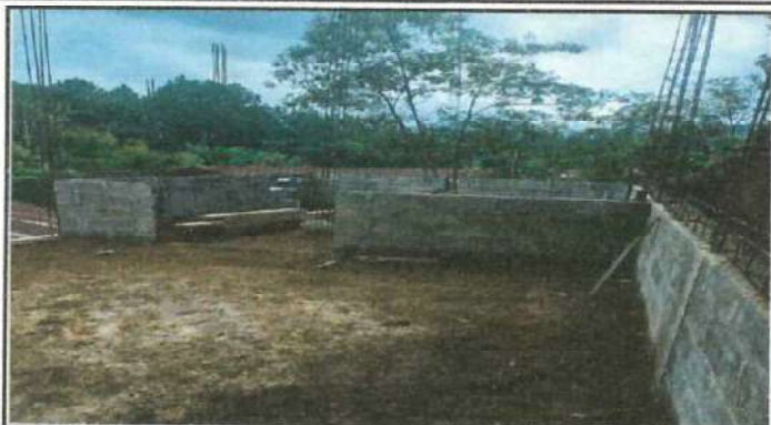
Foto 1: Cocina en culminación de construcción, y falta de entechado.
