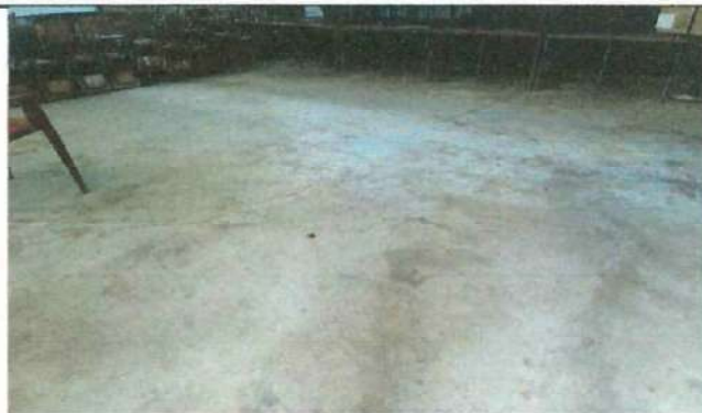
Foto 2: piso torta en deterioro con necesidad de instalacion de piso ceramico.
