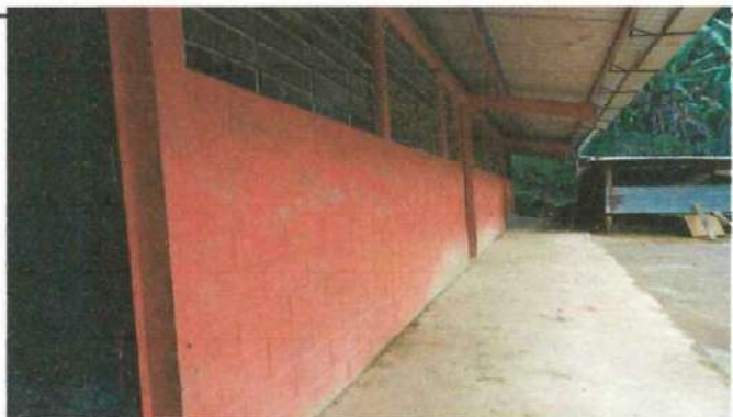
Foto 3: Paredes con necesidad de cerniado, pulido.
